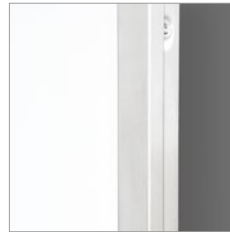
Przyłga zabezpieczona profilem ze stali nierdzewnej
