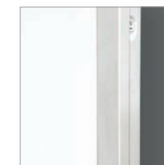
Przyłga zabezpieczona profilem ze stali nierdzewnej
