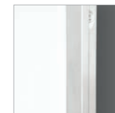
Przyłga zabezpieczona profilem ze stali nierdzewnej
